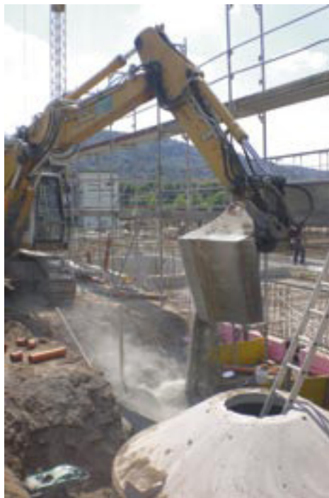
Zisterne zur Nutzung des Regenwassers
